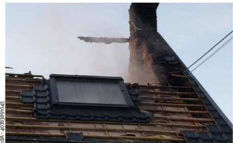
La toiture du domicile a été gravement touchée.
